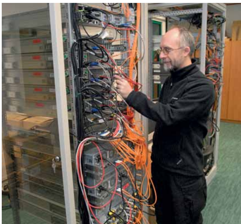
S. Sokół w głównej serwerowni UCI
