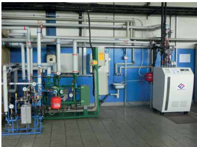
Widok na agregat chłodniczy i węzeł ciepłny
