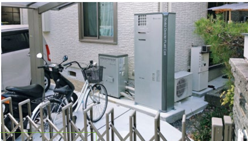
Ilustracja 1. Stos ogniw paliwowych typu SOFC firmy ENE-FARM zainstalowany przy japońskim domu w Kioto
